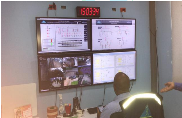
Foto 7. Sistema de alarmas SCADA
